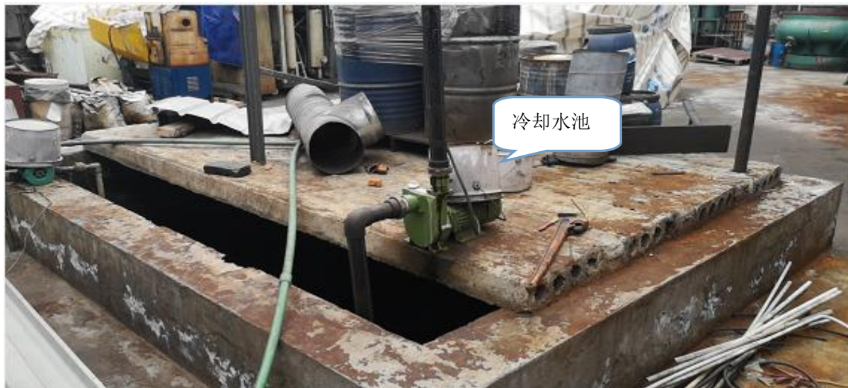
附图 8：废水处理设施照片
